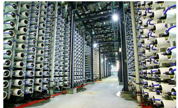
Fig. 22 : Usine de dessalement d'Ashkelon (Israël) - 320 000 m 3 /
