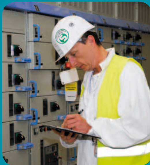
Ronde de surveillance électrique.
